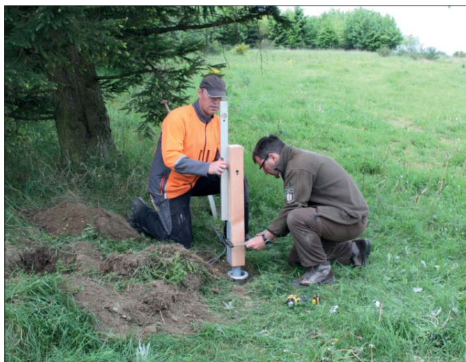
Der Aufbau der Besucherzählgeräte – hier auf der Dreiborner Hochfläche – erfolgte durch Ranger der Holzbauwerkstatt und der Nationalparkwacht.
