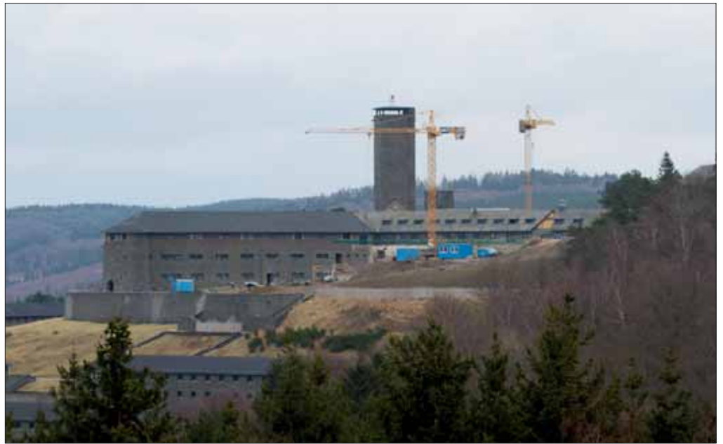
Abbildung 372: Mit umfangreichen Bauarbeiten wird die Anlage Vogelsang unter Berücksichtigung von Denkmal- und Artenschutzauflagen für die Zukunft vorbereitet (Foto: Andreas Pardey)
