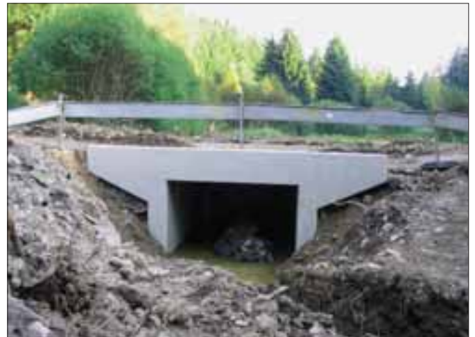
Abb. 33: Zur Wiederherstellung der Durchgängigkeit von Fließgewässern werden Bachverrohrungen unter Wegequerungen durch breitere Durchlässe ersetzt (Foto: A. Pardey)
