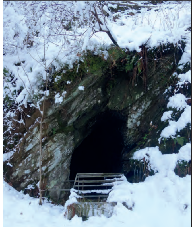
Bei der winterlichen Stollenkontrolle für das Fledermaus-Monitoring fanden Mitarbeiter dieses zerstörte Stollengitter.
