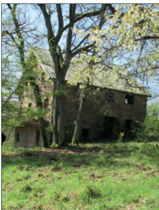
Die sog. Villa Bach aus den 1930er Jahren stellte wegen Einsturzgefahr einen besonderen Gefahrenpunkt dar.
