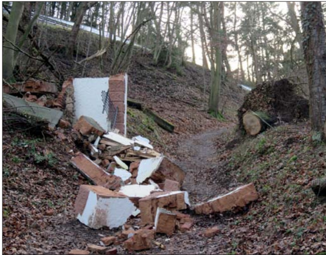
Ein mächtiger Baum hatte das Stationshäuschen VII des Kreuzweges von Heimbach nach Mariawald während des Orkantiefs Friederike 2018 zerstört.
