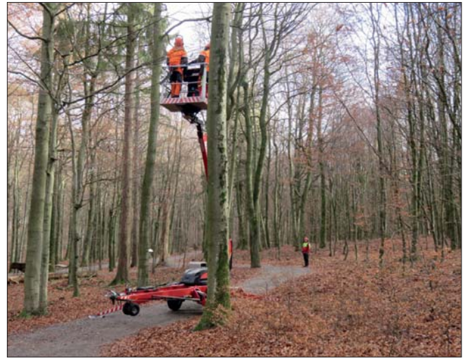
Verkehrssicherung am barrierefreien Wilden Weg: Herabstürzende Äste können zur Gefahr für Besucherinnen und Besucher werden. Per Hubsteiger gelangen Mitarbeiter des Verkehrssicherungsteams bis in die Baumwipfel.
